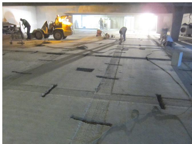
Bild 1 Fertigteilfugen in einem Parkhaus nach Abfräsen der Alt-Bandagen (PAK-haltig) und Anlegen der Verstärkungsnut
