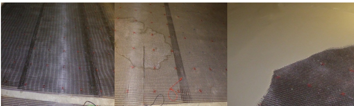
Abbildung 9- Die Verlegung und Fixierung der zwei Gewebelagen mit Abstand zu einander und zum Untergrund (links), die Verlegung und Fixierung des einlagigen Gewebes mit Abstand zum Untergrund (rechts) Abbildung 10- Vergießen des Mörtels auf diese Flächen
